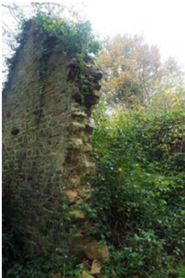
Figure 4 : mur de façade endommagé
