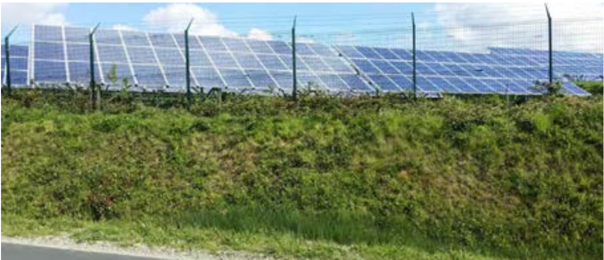
Figure 7 : photo d'installations photovoltaïques
