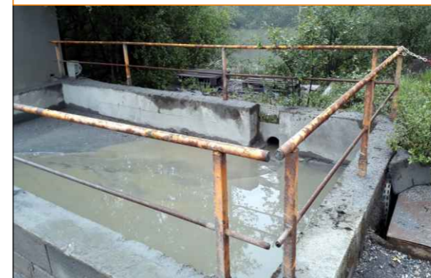
Débourbeur déshuileur (Bassin Richier)
