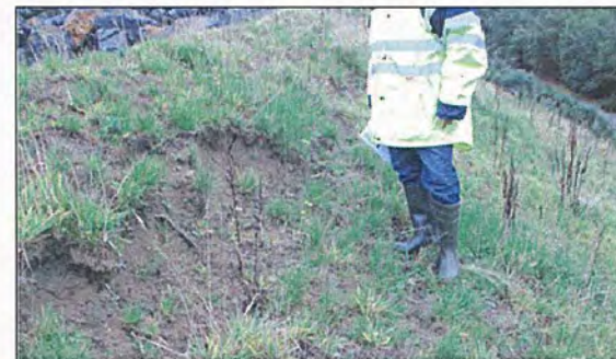
Photo 6 : Instabilité observée au niveau du talus Ouest
