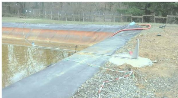
Figure 9: Sonde de niveau du bassin de rétention
