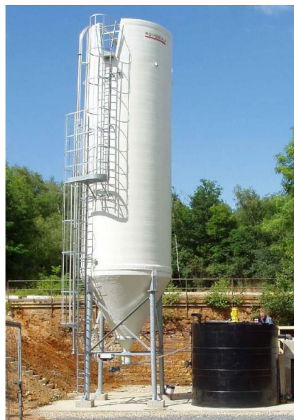
Illustration 9 : Silo à chaux.
