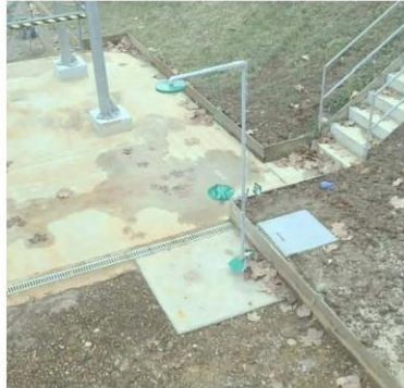
Figure 6: douche de sécurité
