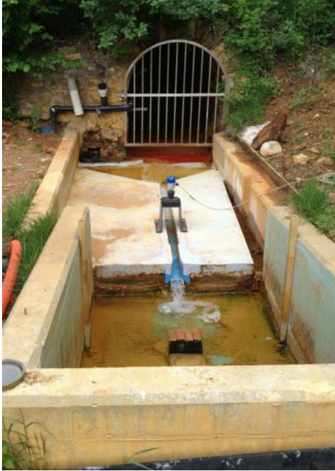
Illustration 1 : Point de captage en sortie de la galerie principale.
