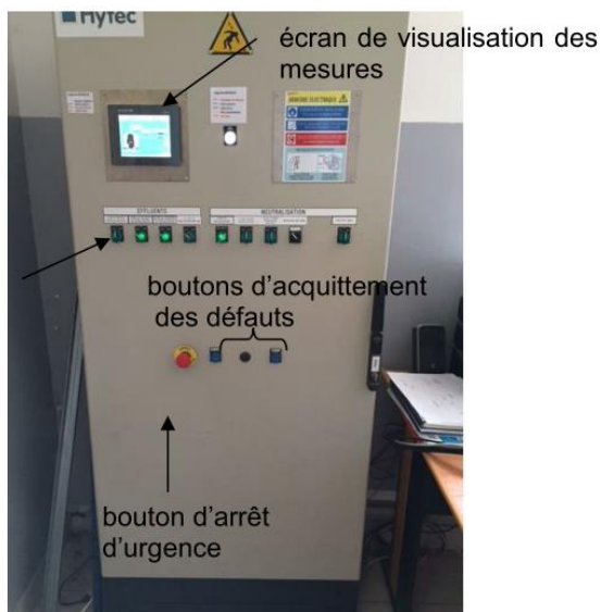
Illustration 8 : Armoire de contrôle de la station.
