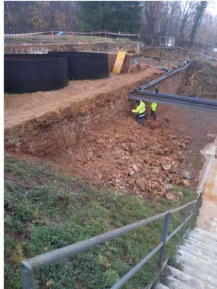
Figure 4 : Partie supérieure du mur démolie
