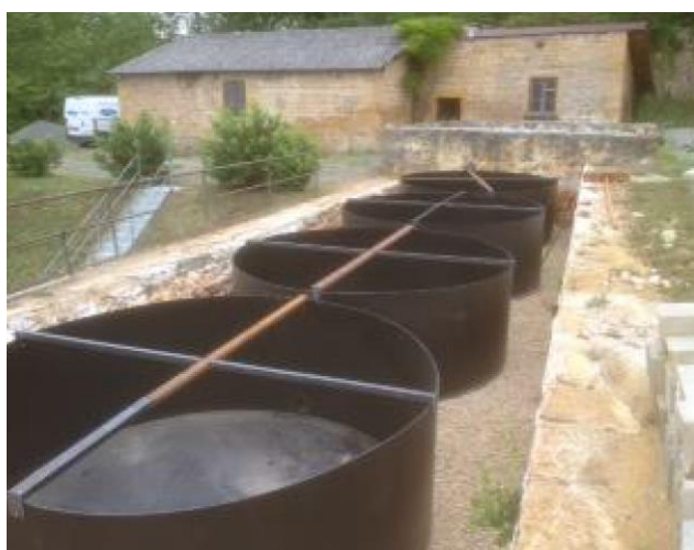
Illustration 10 : Cuves de traitement manuel (avant mise en place de l'agitateur automatique).
