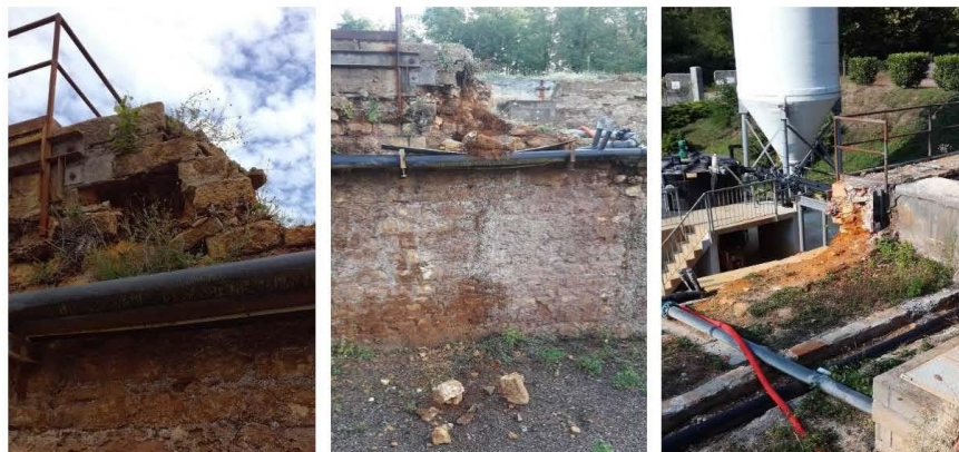
Figure 1 : Muret avant, après éboulement et après travaux de sécurisation
