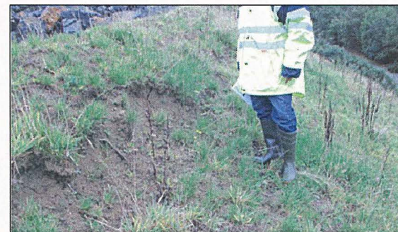
Photo 6 : Instabilité observée au niveau du talus Ouest
