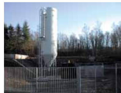
Fig. 2-18 : Station de traitement à la chaux des eaux acides de l'ancien site minier de Chessy-les-Mines (Rhône) (photographie J.-F. Brunet, Brgm).
