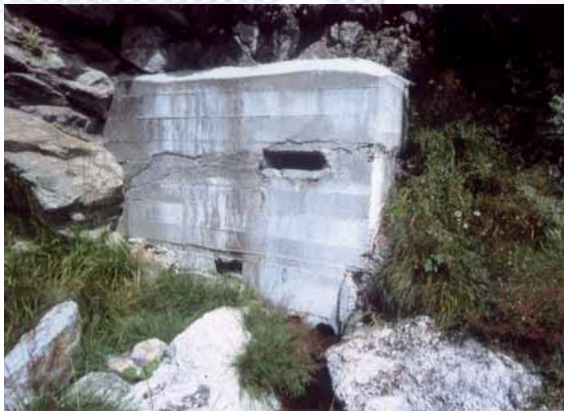
Fig. 3-2 : Ouvrage de la ligne Maginot des Alpes ? Non, bouchon en béton armé sur une des entrées de galerie de l'ancienne mine de plomb argentifère de Peisey (concession du Piscieu, commune de Peisey-Nancroix, Savoie) (photo J. Féraud).
