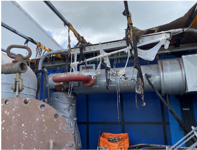
Figure n°5 : équipements de filtration ayant subi les effets thermiques de l'incendie
