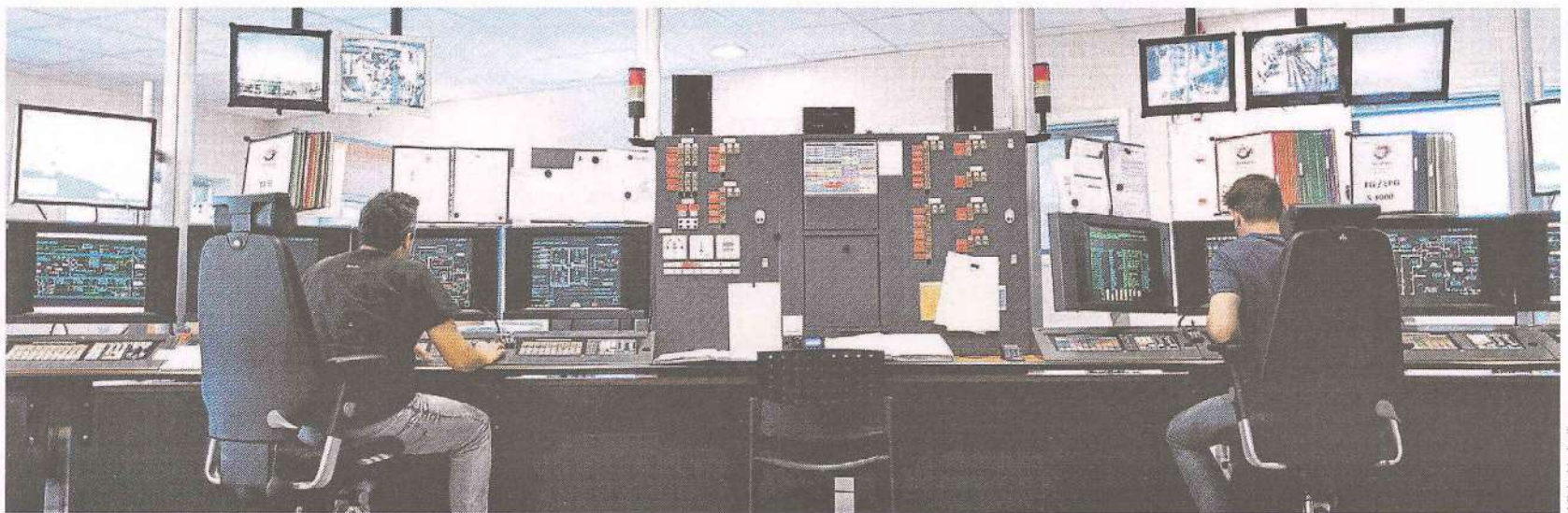
La salle de contrôle de la raffinerie.
