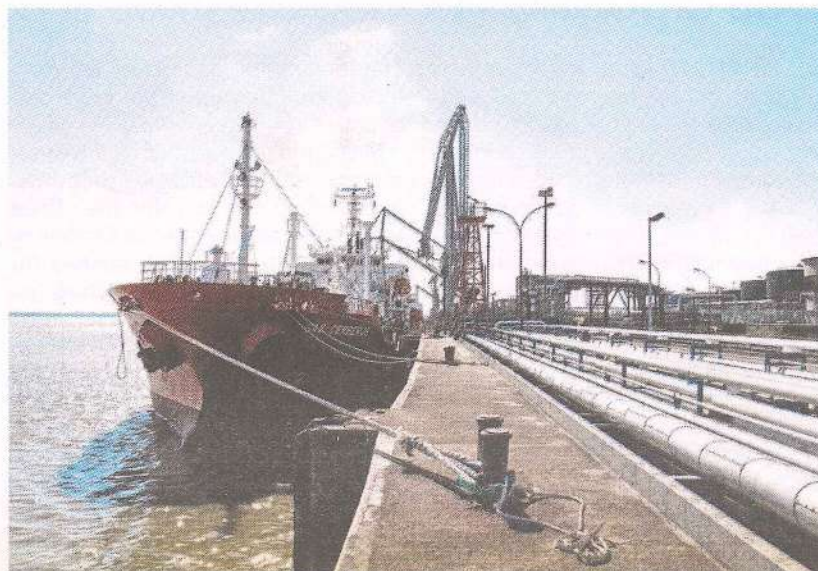
Les bras de chargement et déchargement des appontements sont équipés de double-vannes.
