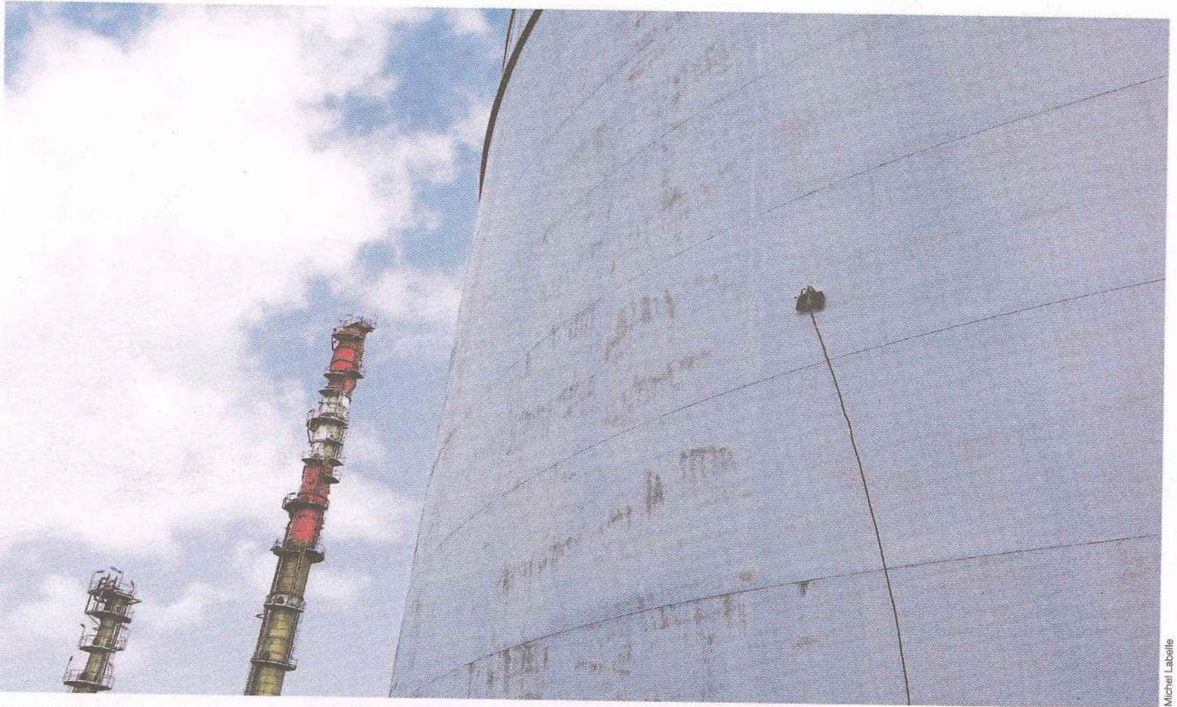
Les robots-scanners facilitent l'inspection métallurgique des bacs en vue des opérations de maintenance.
