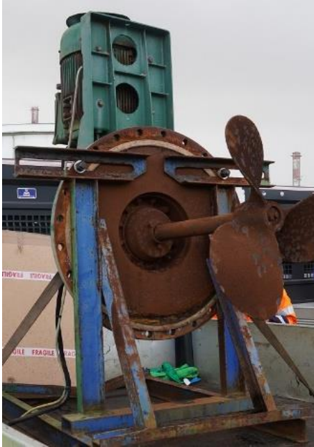
Figure n°2 : photographie de l'hélicomélangeur n°2 après sa dépose suite à la fuite survenue sur l'hélicomélangeur n°1
